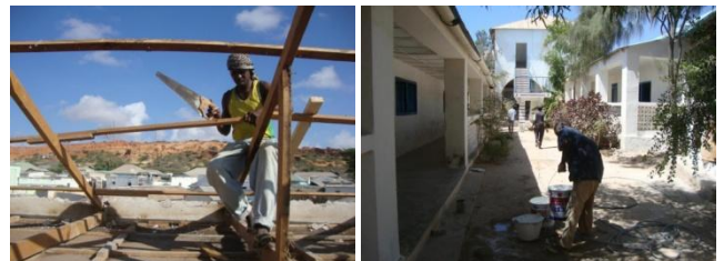
Renovation der Sekundarschule im Frühling 2012. Die Sekundarschule konnte Vre Karrer schon vor zwölf Jahren dank einer grosszügigen Spende aus der Schweiz bauen. 2006 wurde die Schule aufgestockt, um Platz zu schaffen für die sehr stark gewachsene Schülerzahl. Die Gebäude müssen immer wieder instand gestellt werden, da die salzhaltige Luft des Indischen Ozeans die Bauteile angreift.
